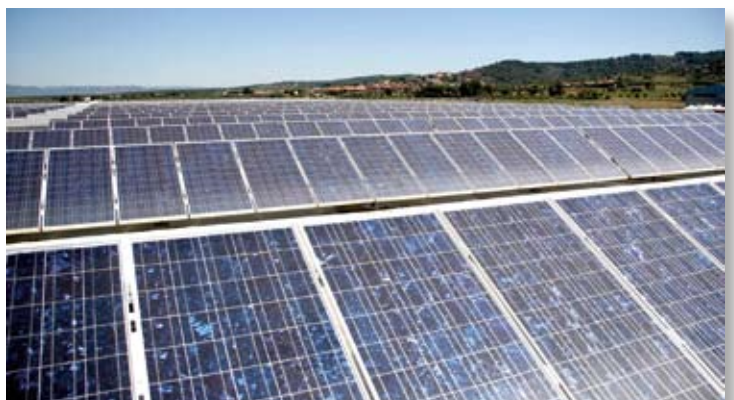
L'impianto fotovoltaico sul magazzino di Vignale (LI), sede di Unicoop Tirreno.
